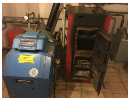
Alte Heizöl- und Festbrennstoffheizung Fotoquelle: Fam. Romirer
