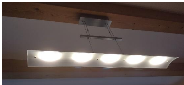
LED-Beleuchtung © Regionalenergie Steiermark
